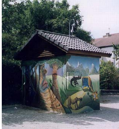
Station fixe de Chambéry-le-Haut
